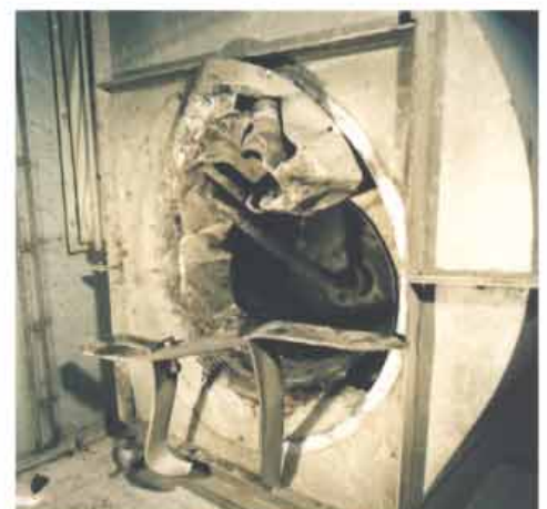
Totalschaden an einem zweiflutigen Radialventilator durch nicht erkannte Resonanzschwingungen
