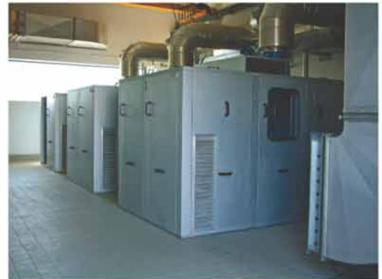
Turboverdichter für die Sauerstoffzufuhr in das Belebungsbecken eines Klärwerks
