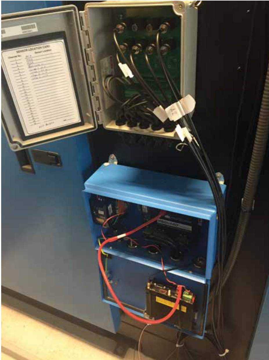
Abbildung 1: Der Verteilerkasten für den Anschluss des mobilen PRÜFTECHNIK VIBXPERT® II war bereits installiert. Dieser wird aktuell für das routenbasierte Monitoring des Kompressors verwendet.
