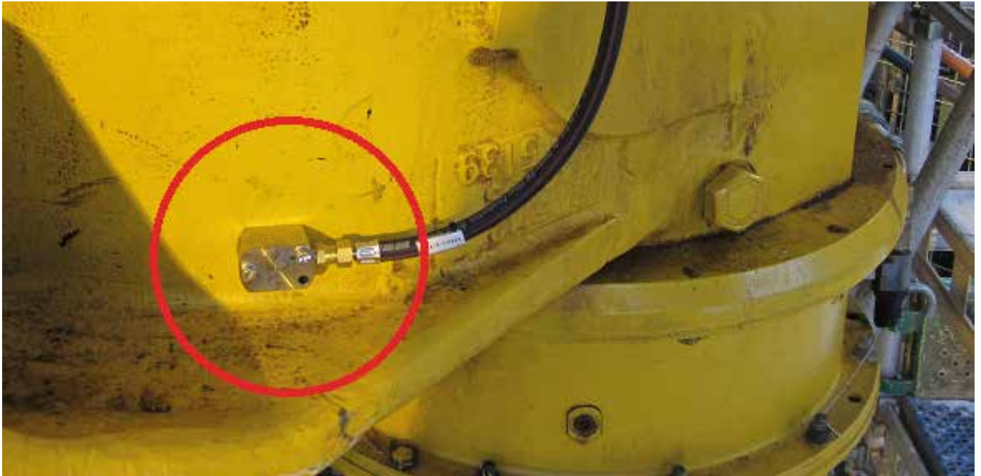
Figura 10: Mini acelerómetro, carcasa y protección del cable de la manguera hidráulica
