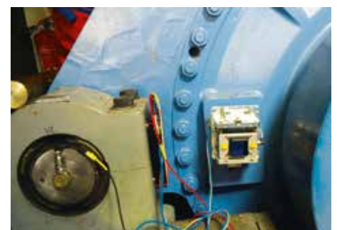
Bild 6a (oben) und 6b (unten) : Montage der Laser/Empfänger-Einheit, links am Hauptlager, rechts am Getriebe zum Ermitteln von Ausrichtvorgaben
