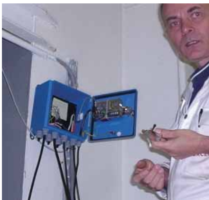
Abb 3: Temporär wurde das Condition Monitoring System VIBNODE® installiert.
