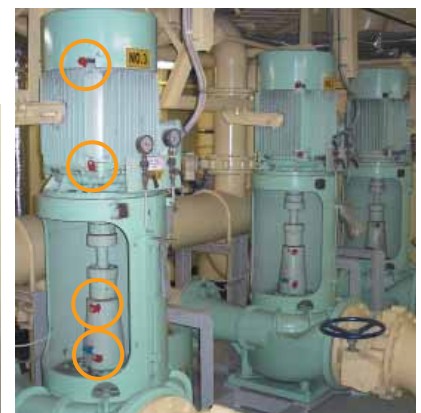
Abb.5: Mit jeweils 4 VIBCODE®-Messstellen ausgerüstete Vertikalpumpen.
